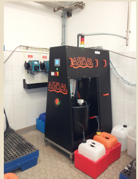
Abb. 2 Chlordioxidanlage in der Landbrauerei Schönram
